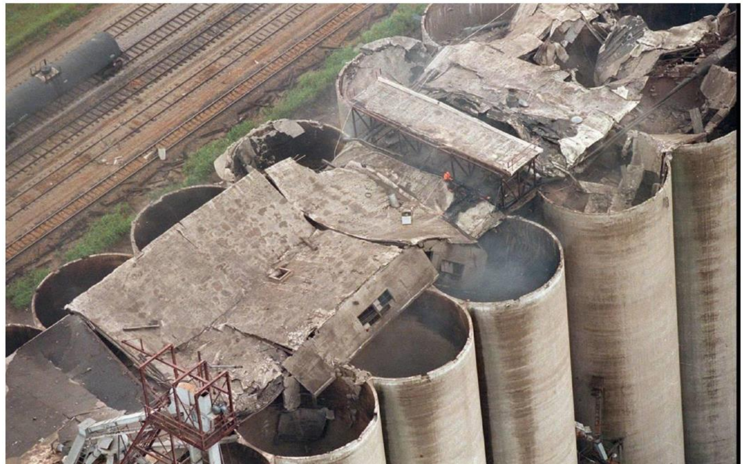
Figura 02: Efeitos da explosão na na galeria sobre os silos da extremidade norte.
